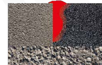
sichere Abdichtung des Anschlusses mit gleichmäßigem Fugenbild mit definiertem Überstand
